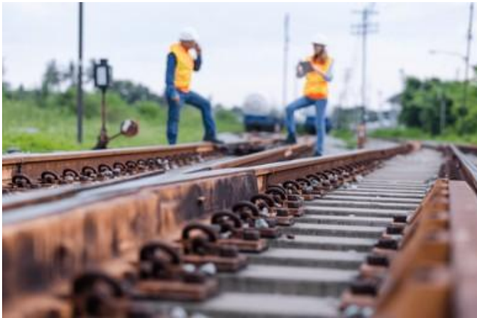
Pemasangan rel kereta api yang renggang sebelum pemuaian - Shutterstock.com.2531956279
